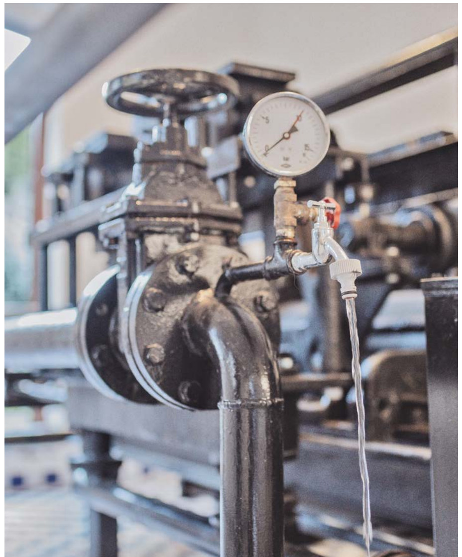
Eine der Lambach-Pumpen wird bei Bedarf in Betrieb gesetzt.
