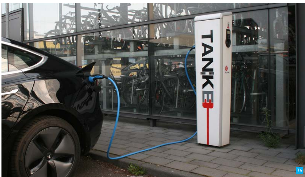
Mobilstation mit Fahrradparkhaus und Infrastrukturen für Elektrofahrzeuge in Bergisch Gladbach
